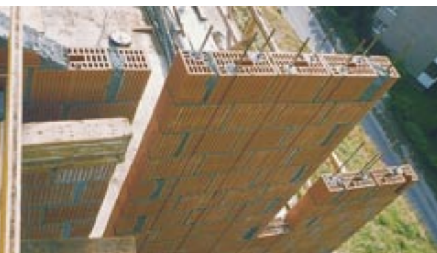
Bauliche Massnahmen für einen besseren Erdbebenschutz: Verstärkte Stahlbetontragwand, Stahl-lamellen zur Verfestigung einer Steinmauer, Querbewehrung einer Betonarmierung und armierte Backsteinmauer.
