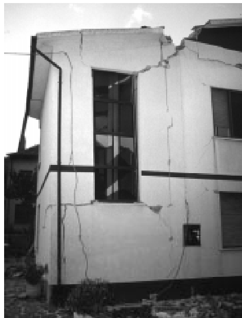
Bild 6: Einfamilienhaus mit groben Rissen um grosse Fensteröffnung
