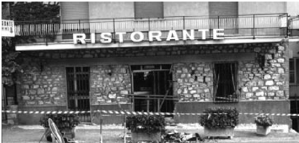
Bild 5: Hotel mit Restaurant: grobe X-förmige Risse in den kurzen Natursteinwänden im Erdgeschoss
