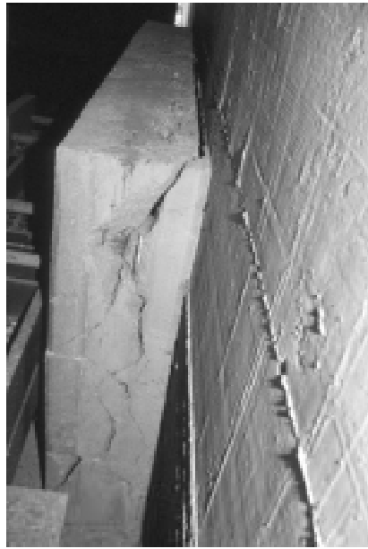
Bild 11: Beschädigte Stahlbetonscheibe des Horizontalkraftlagers n Brückenlängsrichtung auf Widerlagerseite Foligno. Blickrichtung wie in Bild 10c.
